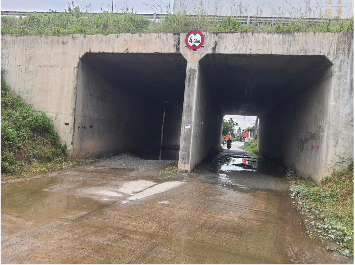
Hình 1. Mặt đường hư hỏng nghiêm trọng (Km135+099)
